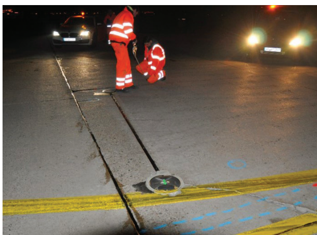
Obr. 5: Poškozená betonová deska se dvěma vestavěnými součástmi
