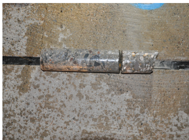
Obr. 6: Jádrový vývrt z betonové desky a podkladní vrstva bez spojení
