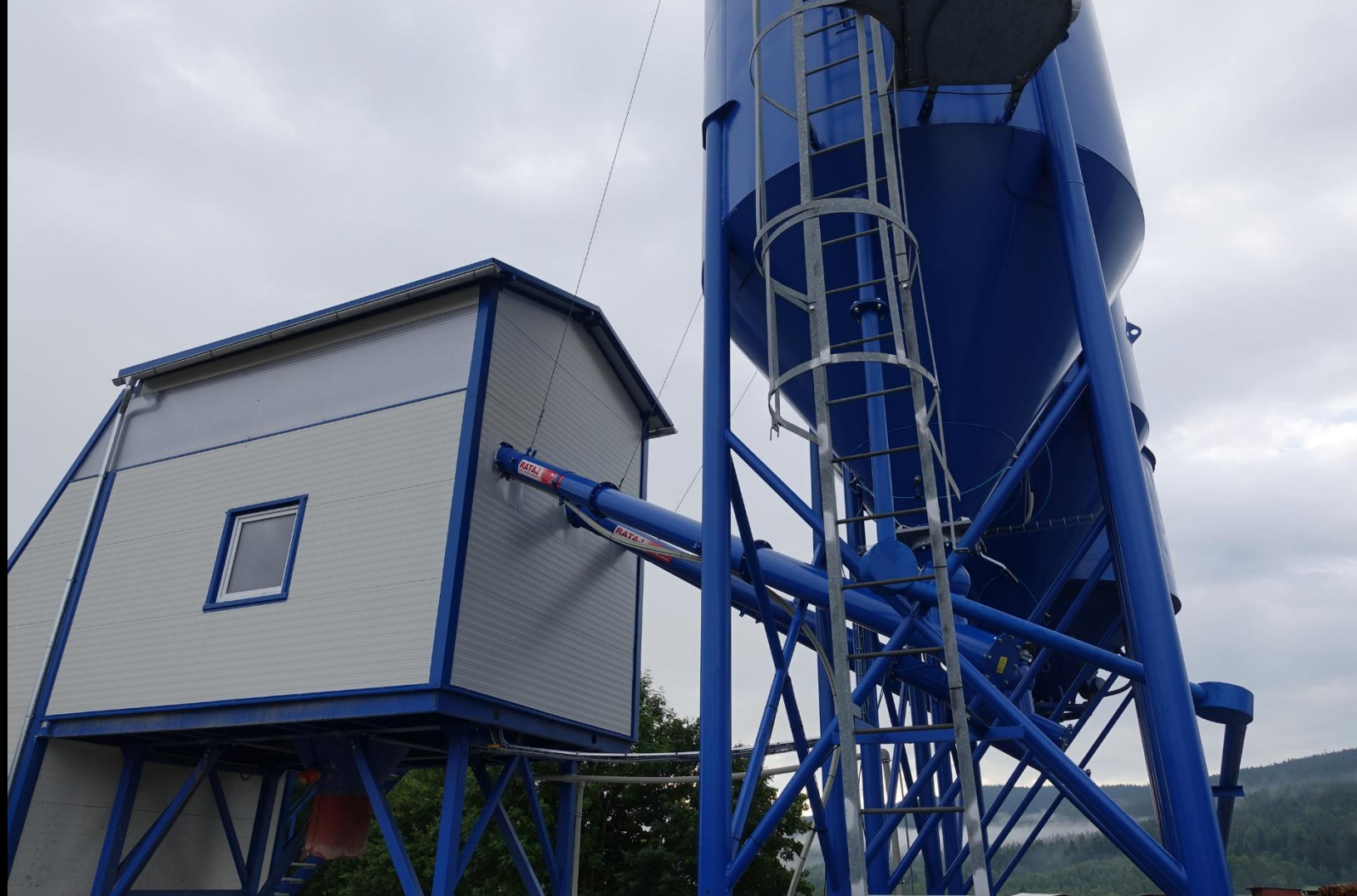
ČR beton Frymburk – cement + písek
