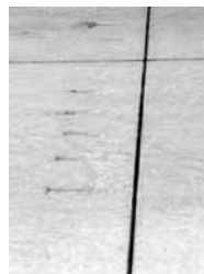
einseitige Dübelmarkierungen an der Querfuge
