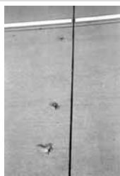
Ausplatzungen aufgrund einer geringen Überdeckung der Dübel
