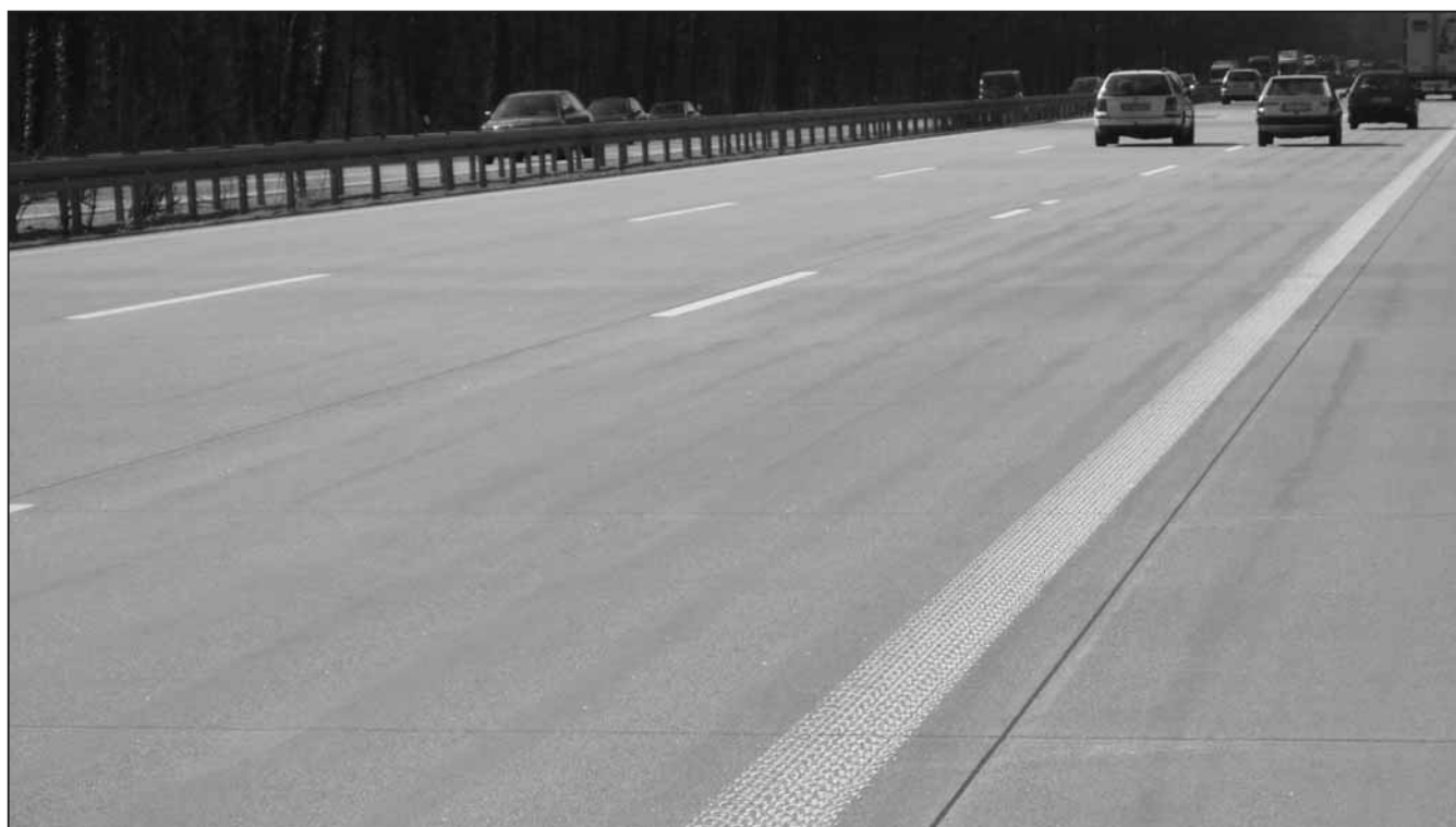
Obr. 2: vozovka s vymývaným betonem
