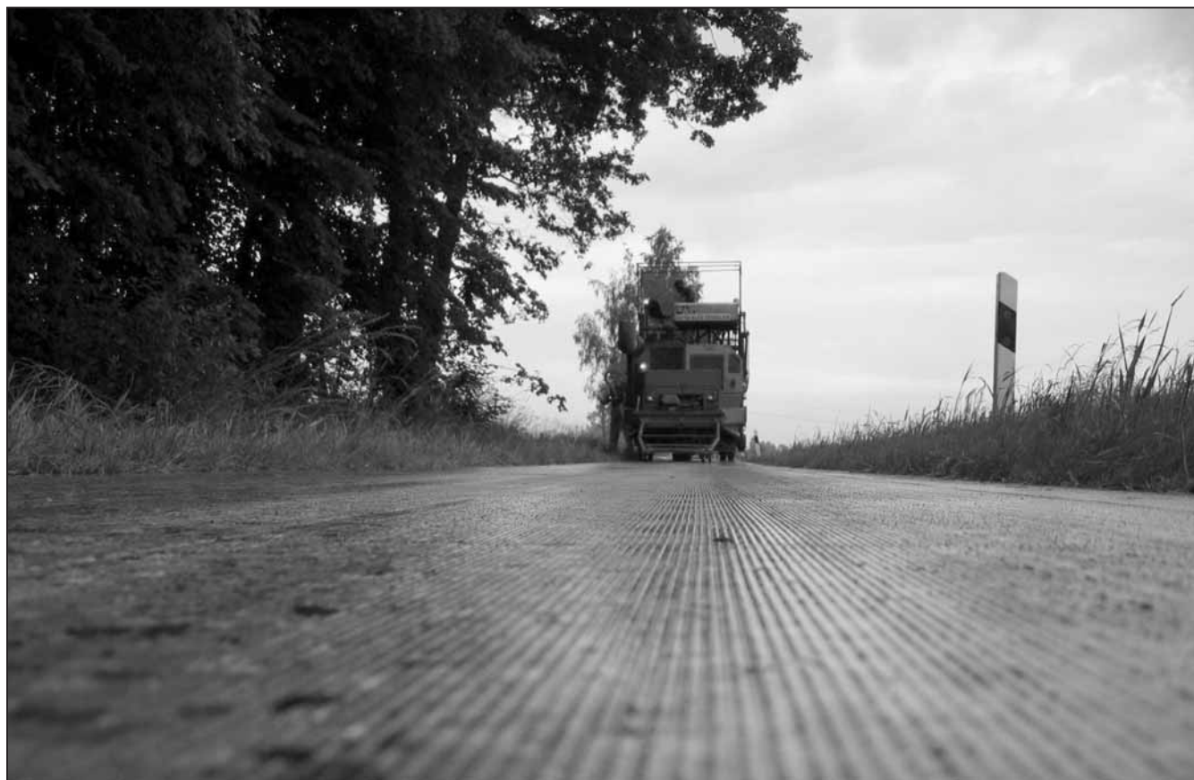
Obr. 5: drsné, nehluchné betonové povrchy po Grinding (broušení)
