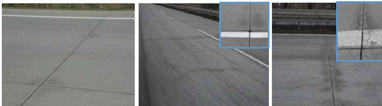
Obr. 7 Charakteristické stupně poškození CBK, zleva stupeň I, II, III [19].
