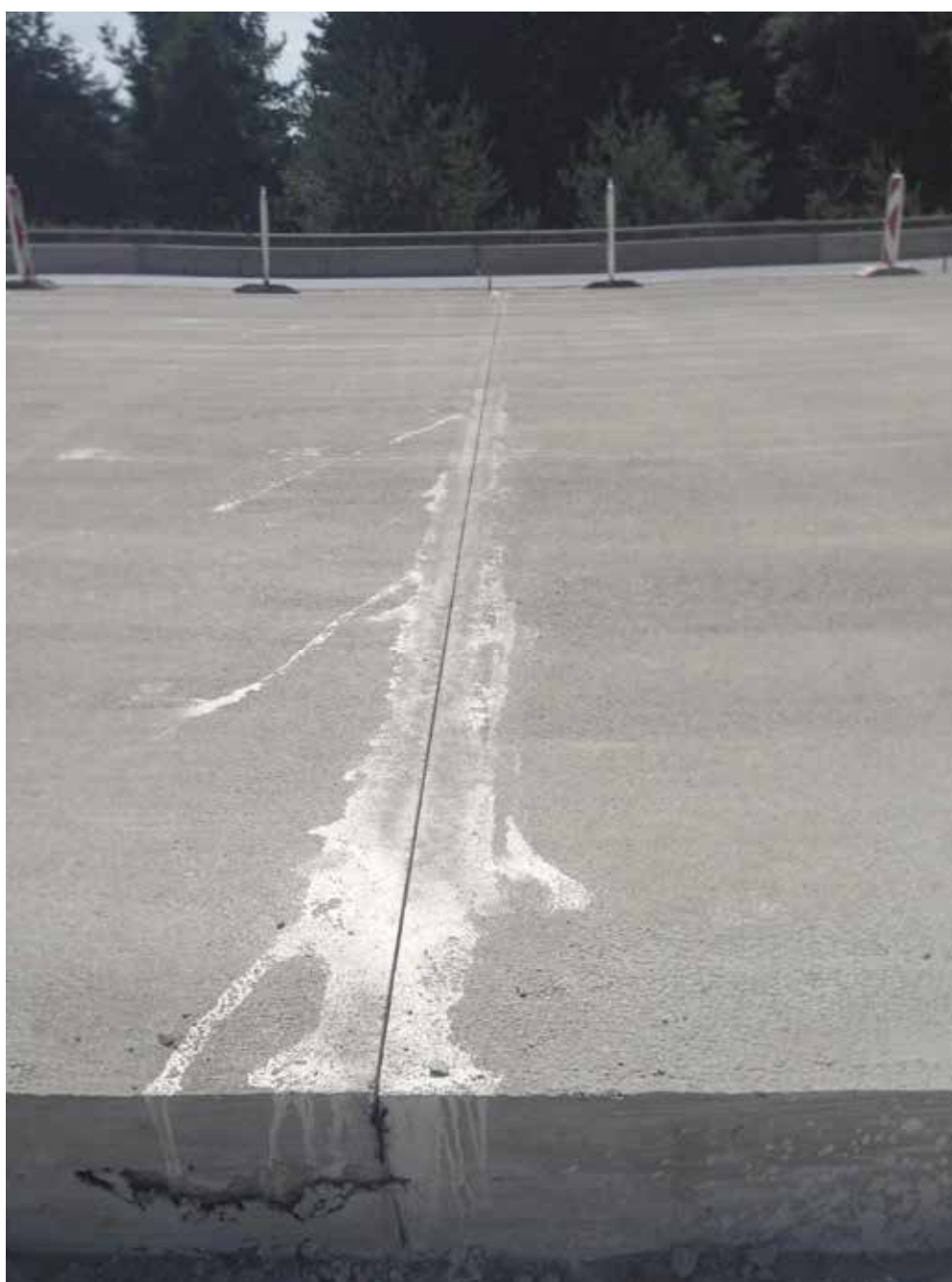
Obrázek 1) Spárořez na úseku 15 – chybné provedení
