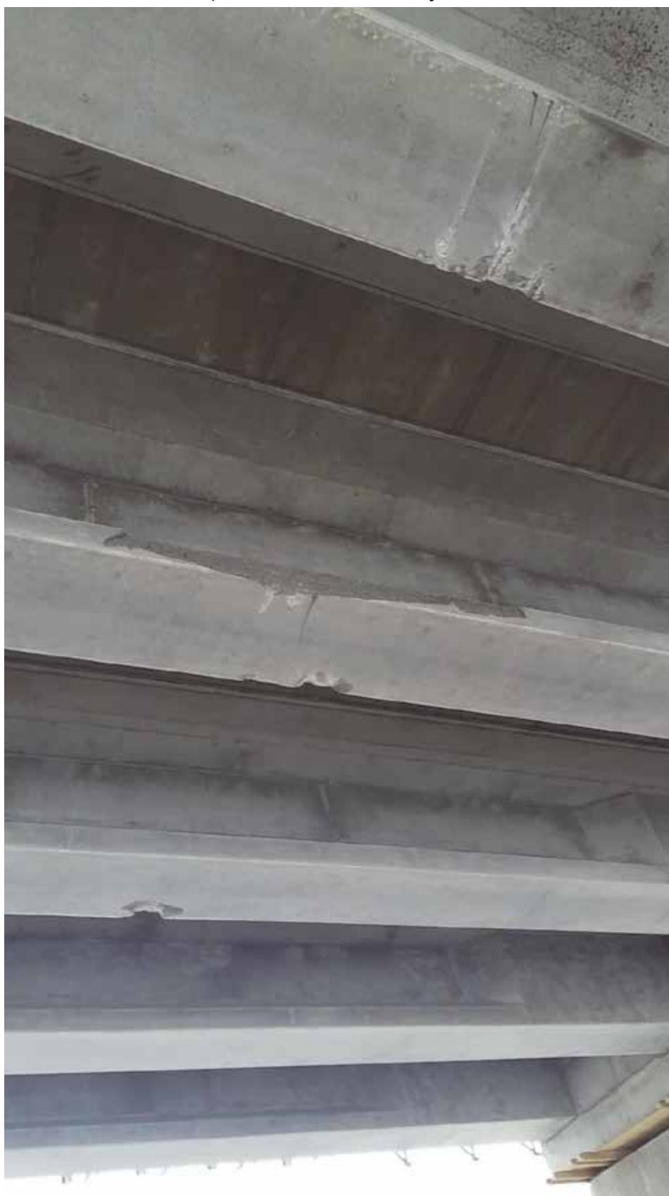
Obrázek 2) Poškozené nosníky na úseku 20
