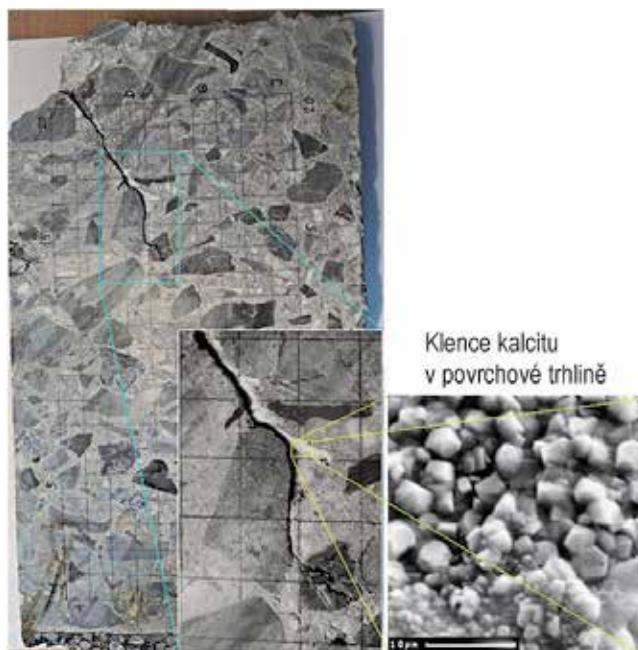
Obrázek 2: Rozříznutý vývrt s mřížkou 10 x 20 cm pro výpočet DRI s detailem trhliny; v tomto případě je DRI = 47.
