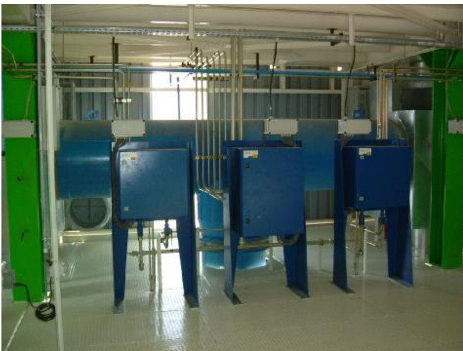
HYDRAULICKÉ SKŘÍNĚ SE SOLENOIDOVÝMI VENTILY A ROZVOD OLEJE
