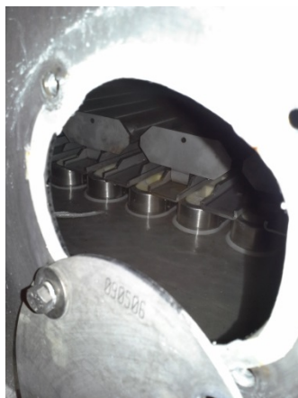
Voda na šlicblechu
